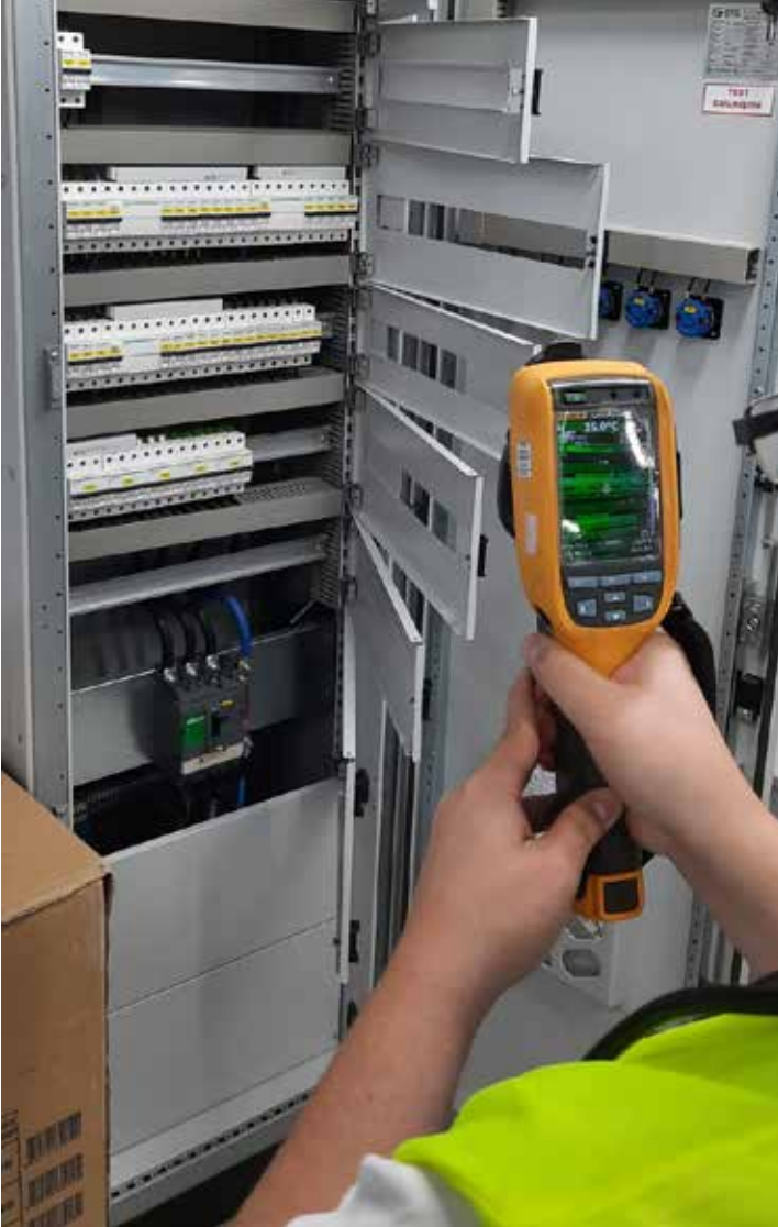
Şekil 11: İç Elektrik Tesisatı ve Topraklama Periyodik Muayeneleri
